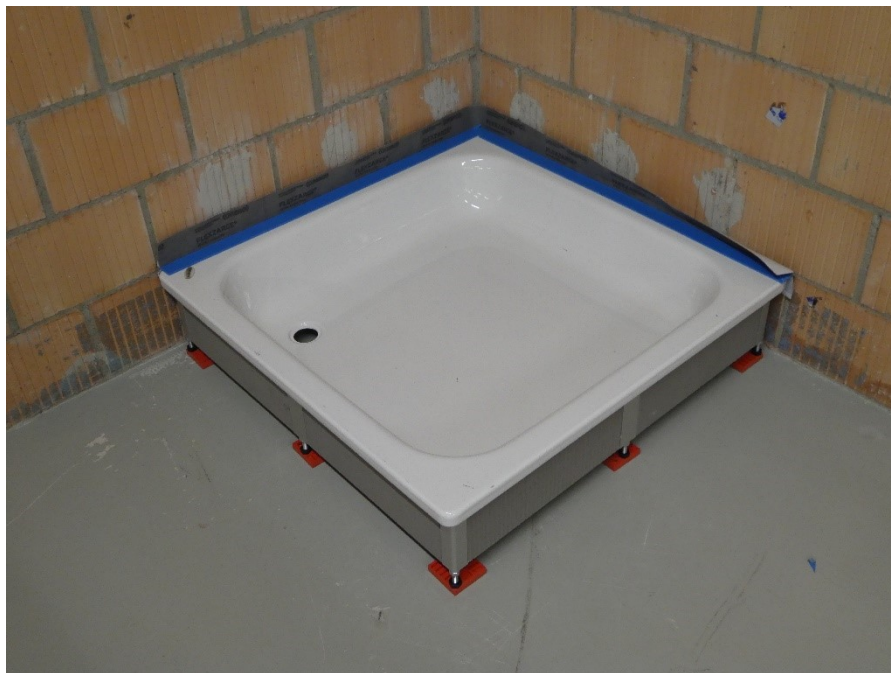
Abbildung 3: Gesamtansicht von Prüfaufbau 1 (Aufbau Nr. 1 vom 02.12.2020)
